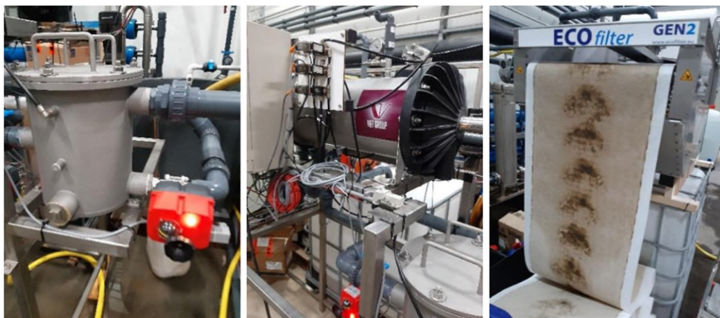
Figuur 4: Filterstraat met van links naar rechts: gaasfilter en MT-IBA filter (Fiber Filtration) en papierbandfilter (Ecofilter).
