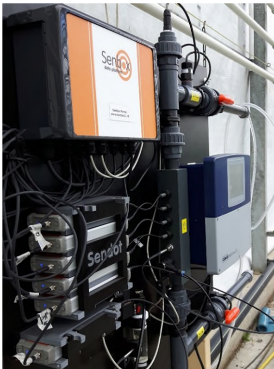
Inline meetsysteem op locatie (foto: Sendot)
