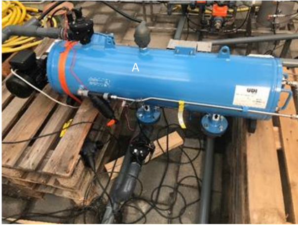
Figuur 2-2 Filterstraat 2 met één filterstap (A).
