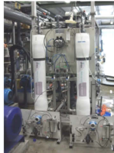
Afbeelding 3. AiRO-opstelling met twee parallelle 8 inch SWM RO-elementen bij Evides Industriewater
